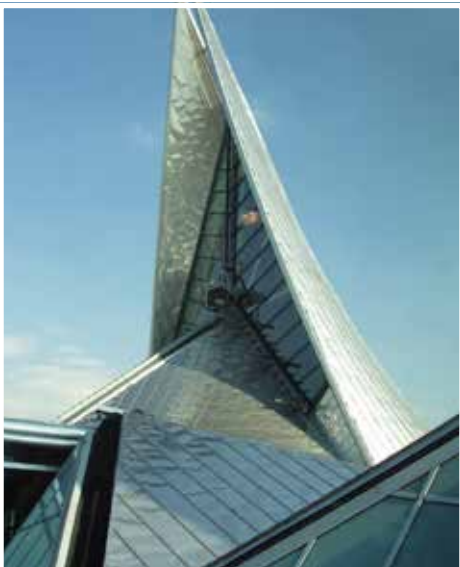
Detail van het dak van het Justitiepaleis, Antwerpen, met rolnaad gelast rvs type 1.4404 (316L) _Détail de la couverture en inox du Palais de Justice, Anvers ; technique de joint soudé en continu, nuance 1.4404 (316L).
