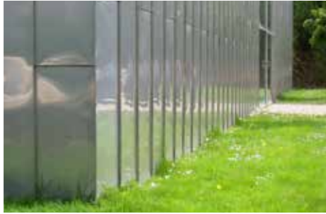
Gevelbekleding in roestvast staal, geplaatst met staande naad, Universiteit Luik. _Bardage extérieur en inox , technique de joint debout, à l'université de Liège.
